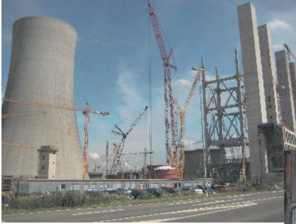
RWE Kraftwerk Neurath
